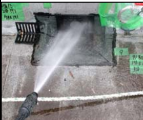
連通ドレン散水状況
