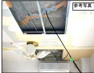
参考写真 リビング天井亀裂箇所
