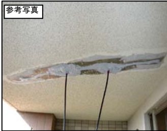
参考写真 バルコニー天井亀裂箇所
